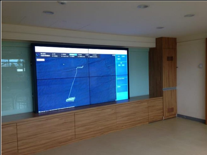
位於漁業署臺北和平大樓之「24小時漁業監控中心」
