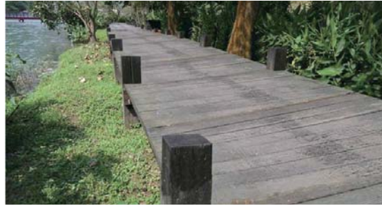
圖 9 改善後為平緩的坡道，便利高齡者及輪椅族通行
