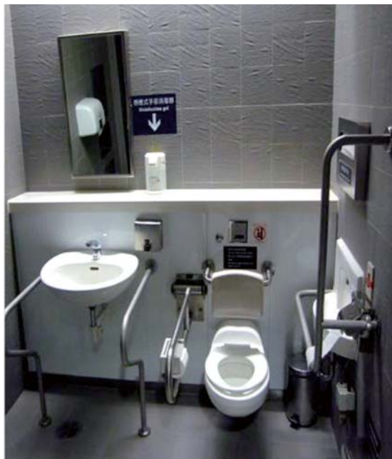
圖 2 廁所內馬桶、洗面盆旁邊加裝扶手及設置求助鈴
