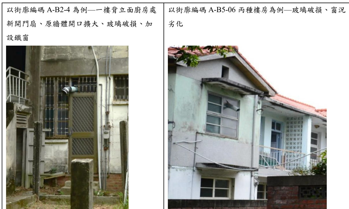
圖 4-69 門扇損壞狀況—機能性 (資料來源：本計畫整理)
