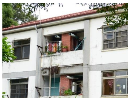
圖 4- 71 其他損壞狀況—結構性 (資料來源：本計畫整理)
