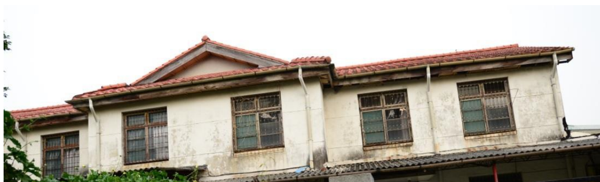
以街廓編碼 A-B1-01 甲種、乙種、丙種樓房為例—加裝冷氣、加裝鐵窗、加裝廚房管線、加蓋屋簷等
