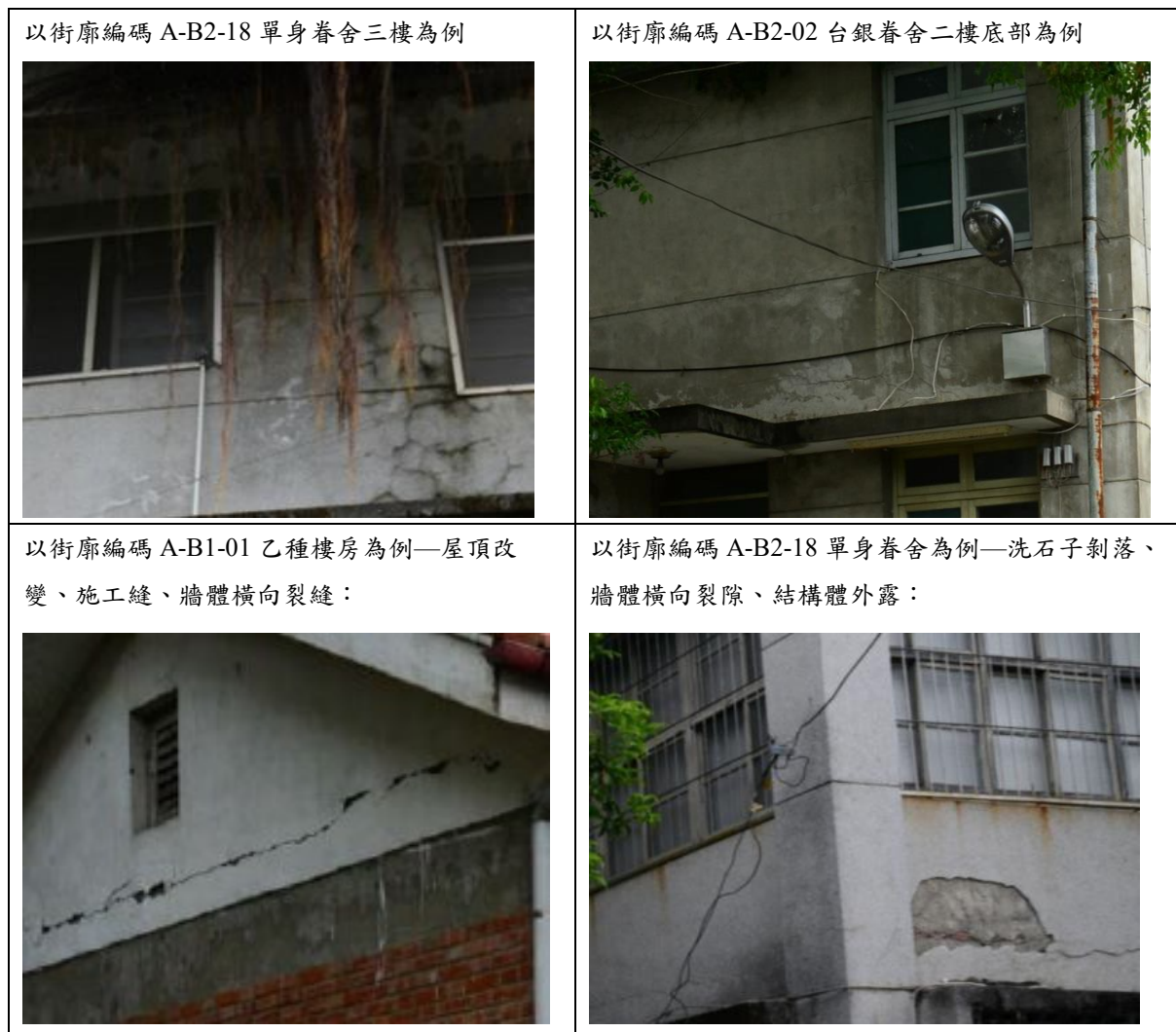
圖 4-66 牆體損壞狀況—結構性
