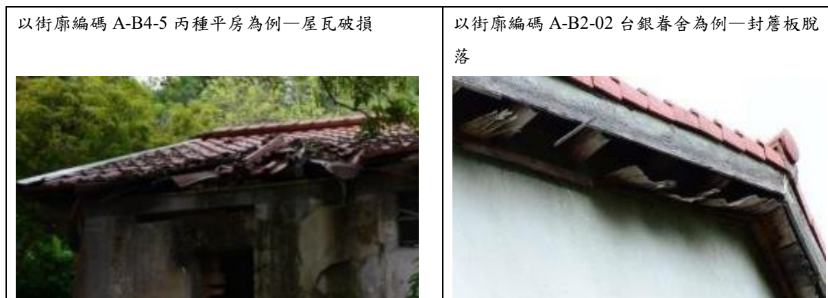
圖 4-60 屋頂損壞狀況—機能性 (資料來源：本計畫整理)
