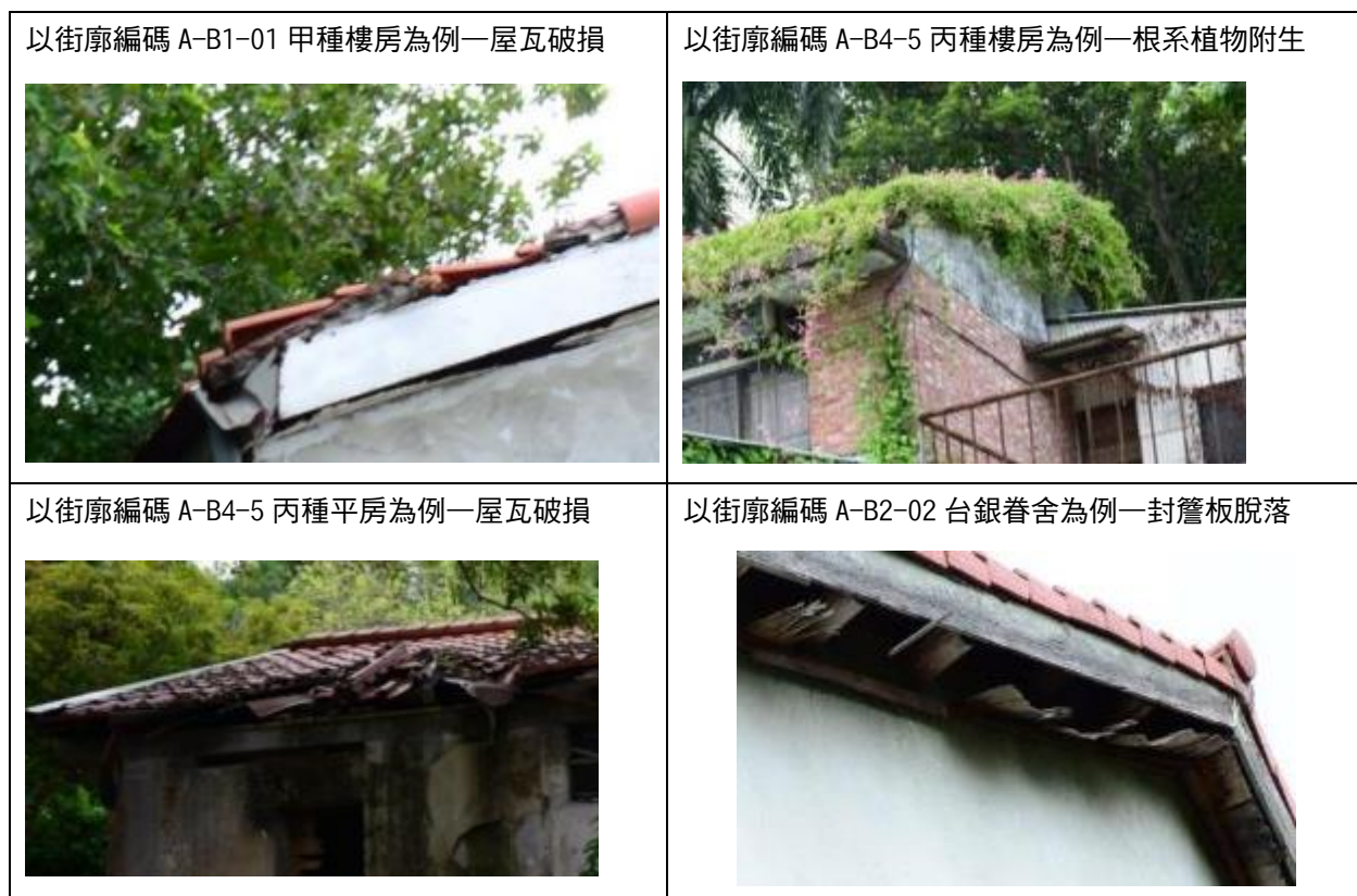
圖 4-62 屋頂損壞狀況—機能性
