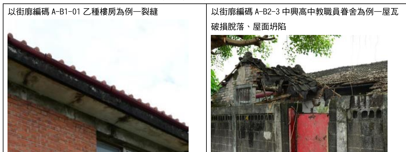
圖 4-61 屋頂損壞狀況—結構性
