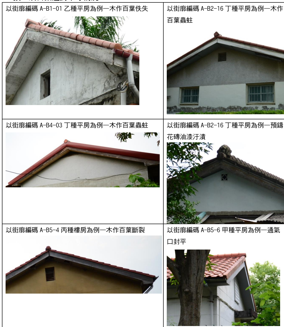
圖 4-73 山牆通氣孔損壞狀況—機能性
