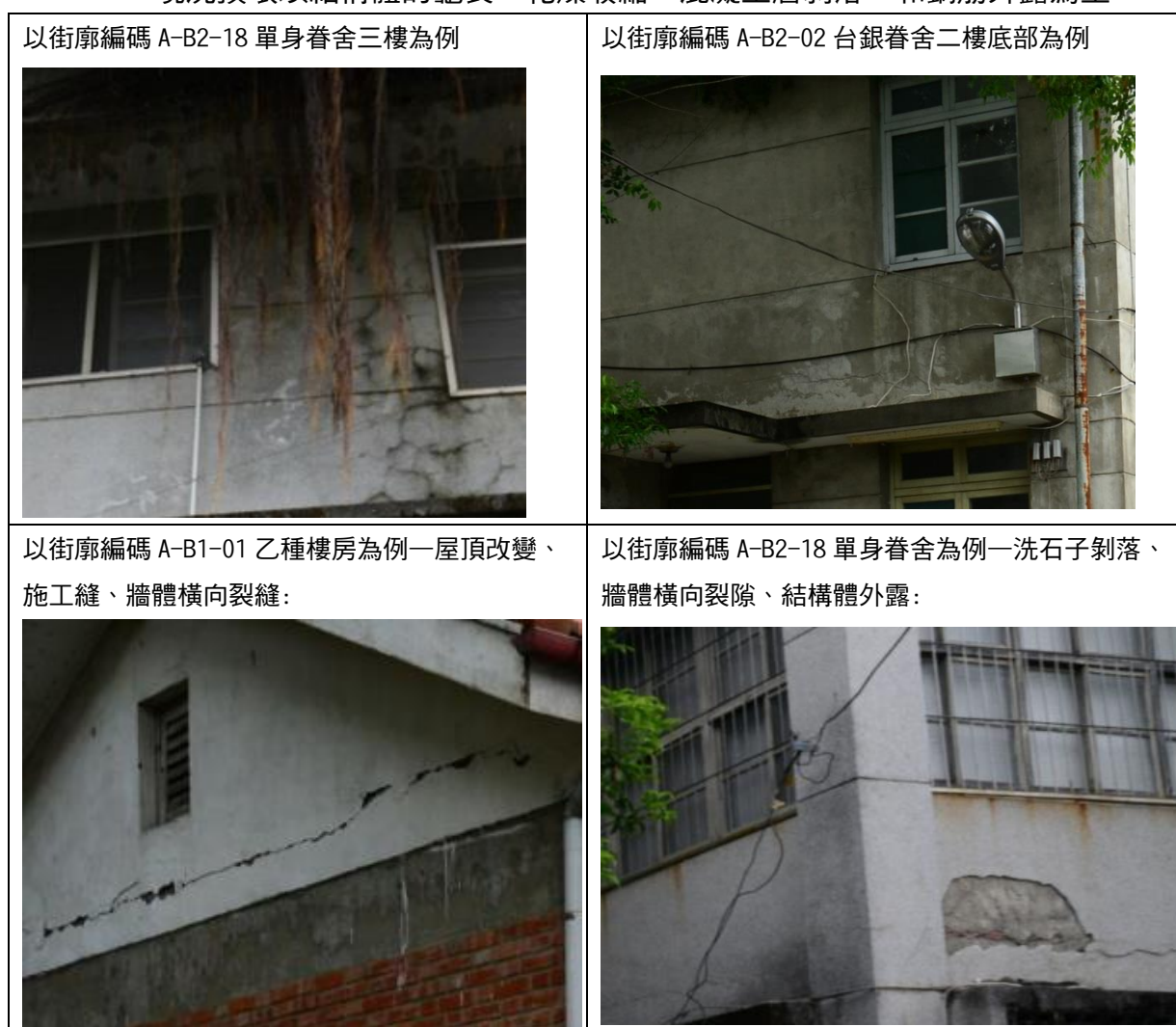
圖 4-70 牆體損壞狀況—結構性
