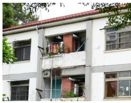
圖 4-77 其他損壞狀況—結構性
