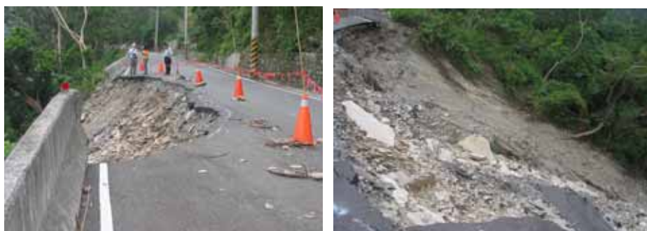
照片 2-93 S-24 受災情形(屏 31 號公路距三地門鄉之德文村約 800m)
