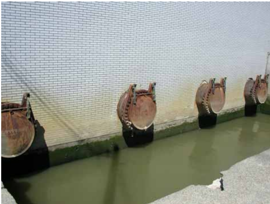
圖 2-8 新山寮抽水站出水口
