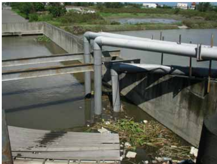
圖 2-10 海南村簡易排水設備
