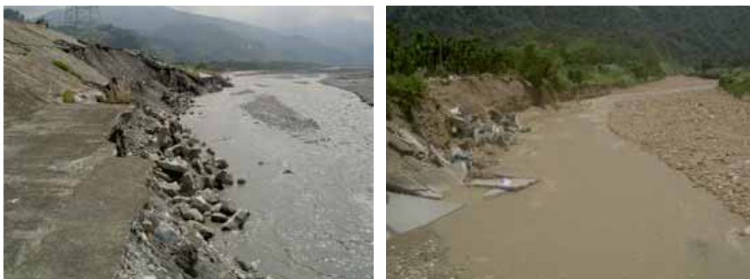
相片 41 大安溪內灣堤防之破壞情況（左），南港溪壽全橋上游之破壞情況（右）
