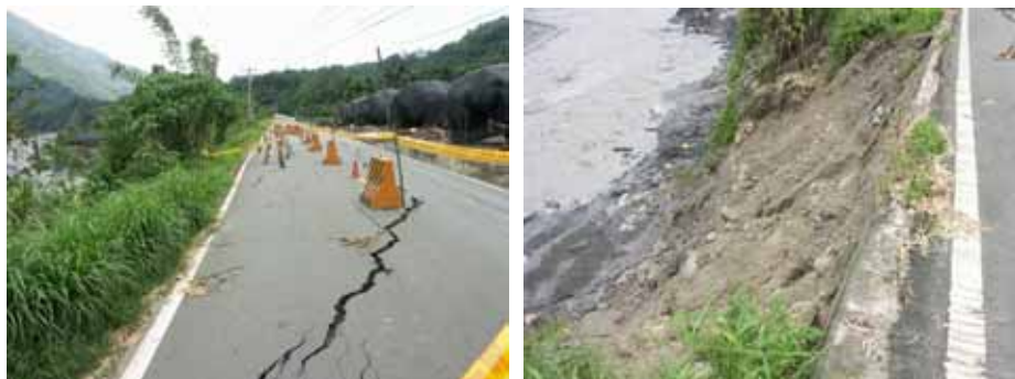
照片 2-62 S-02 災損情形(台 20 線高中檢查哨北方 200m)
