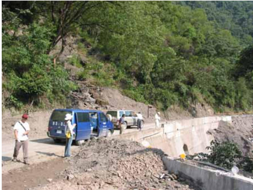
照片 2-69 S-07 災損情形(台 20 線 101k+500)
