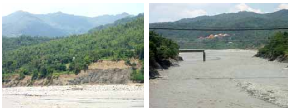
照片 2-84 S-18 災損情形(台 27 號公路 9K+500)
