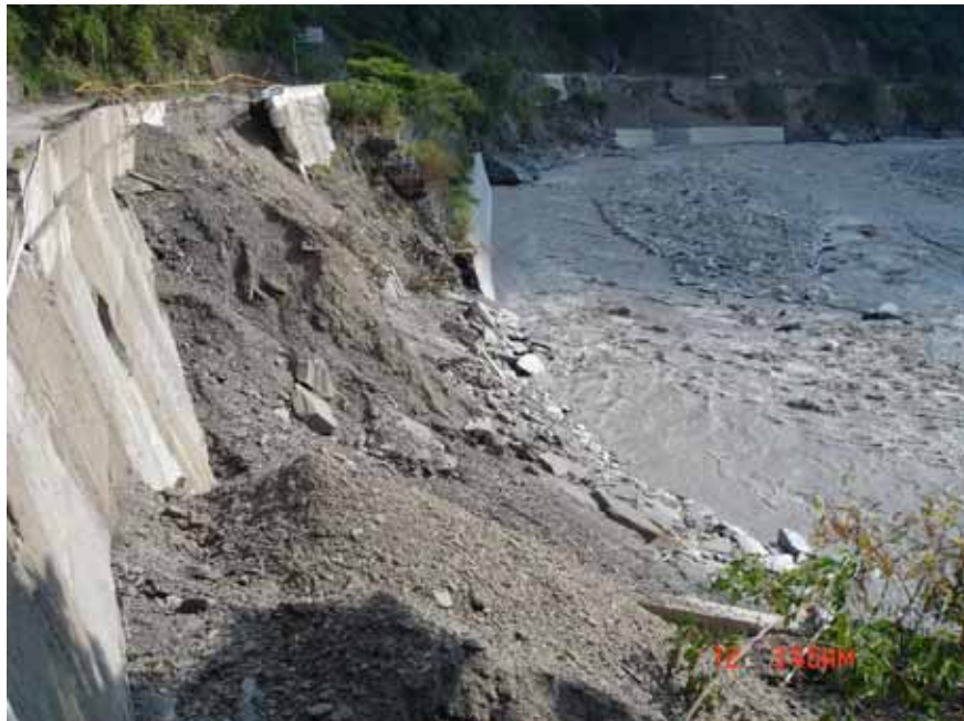
照片 2-70 S-07 災損情形(台 20 線 101k+500)
