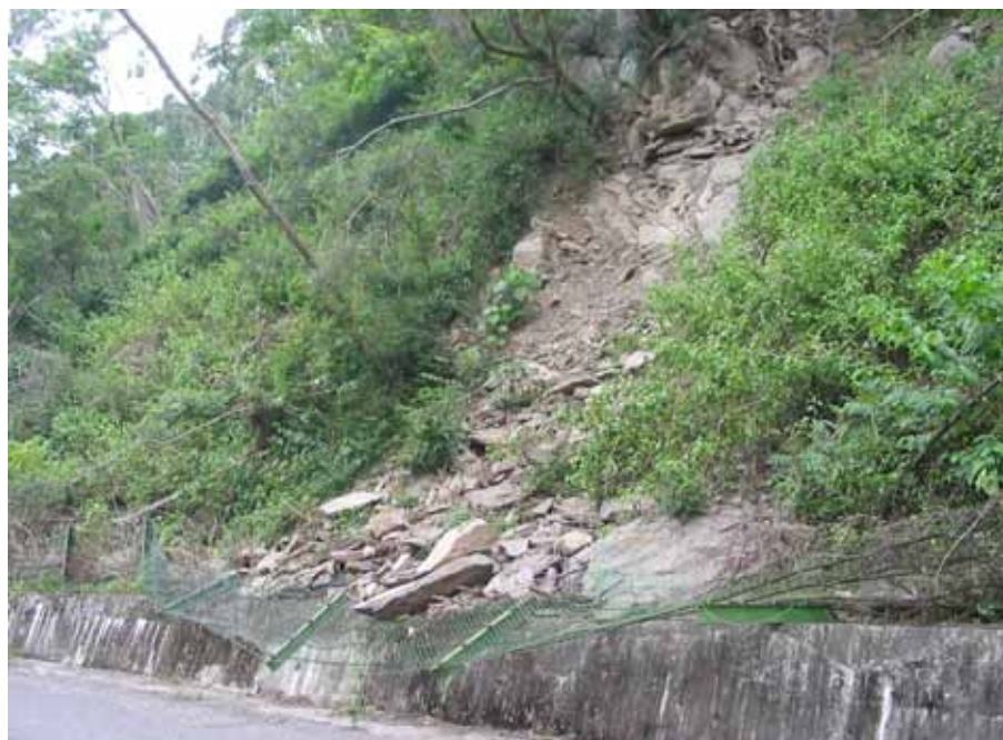
照片 2-94 S-25 受災情形(屏 31 號公路往三地門鄉之德文村)
