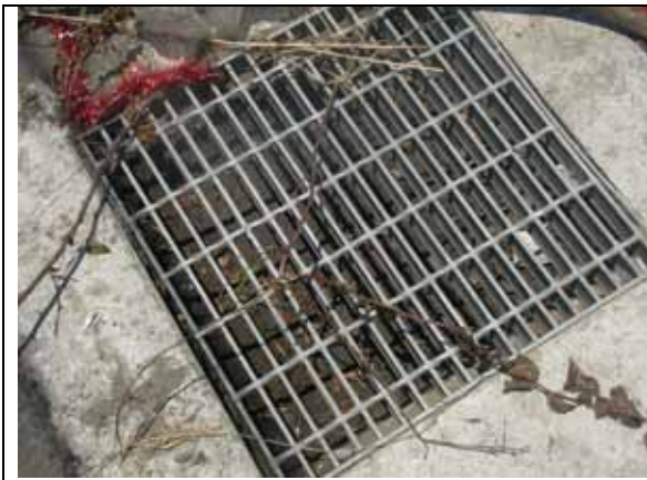
圖 2-18 側溝被雜物阻塞影響排水
