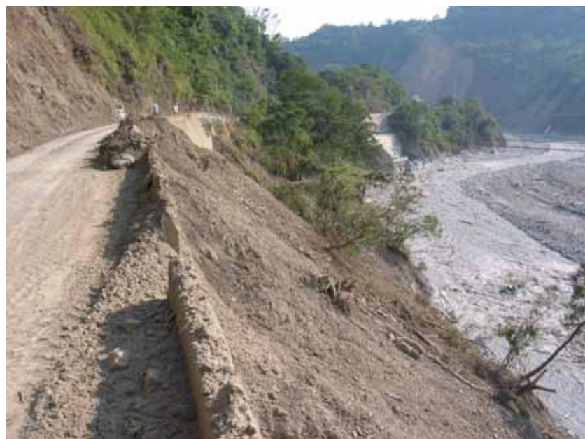
照片 2-68 S-06 災損情形(台 20 線 96k+450)
