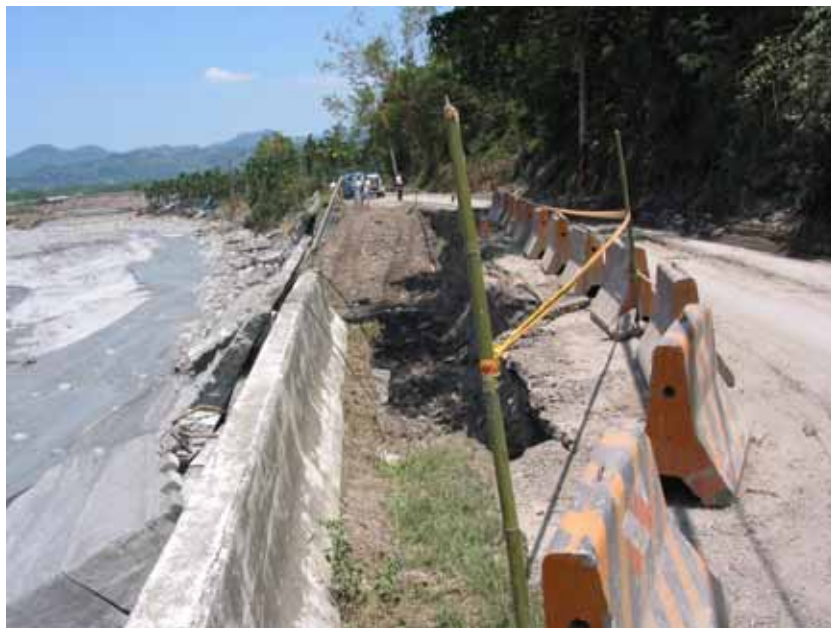
照片 2-88 S-20 災損情形(台 27 號公路 24k+290~+400)
