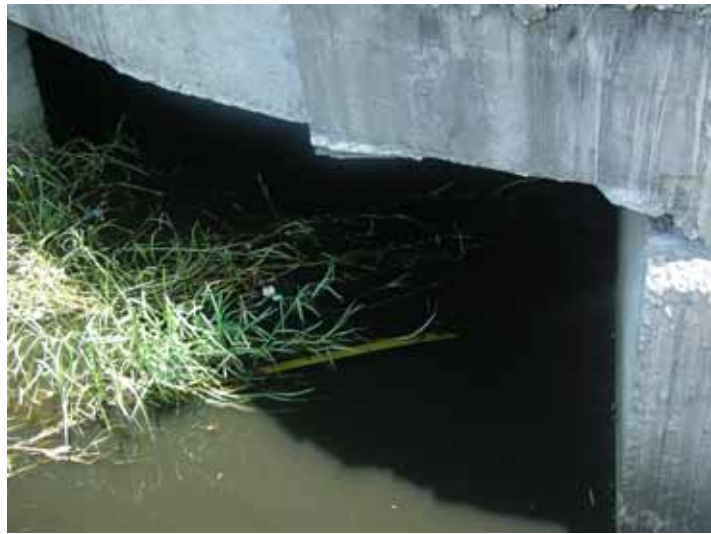
圖 2-20 口湖鄉 1 號路下水道出口淤塞嚴重
