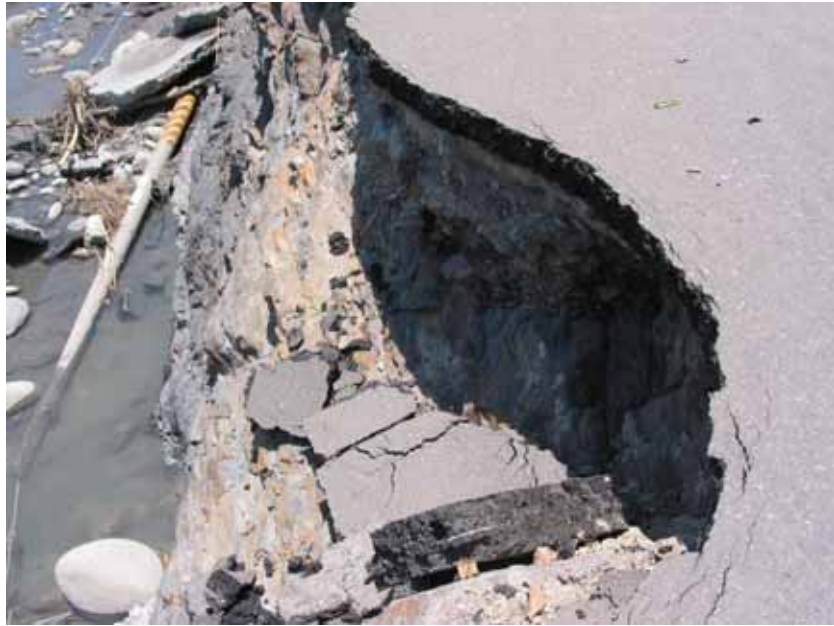
照片 2-87 S-19 災損情形(台 27 號公路 20K+200~+915)
