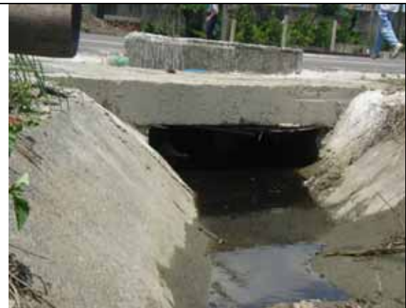
圖 2-19 口湖鄉 1 號路旁之水利會灌溉渠道
