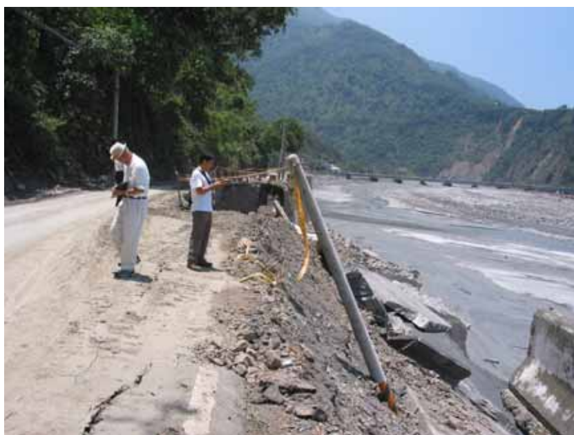
照片 2-89 S-20 災損情形(台 27 號公路 24k+290~+400)
