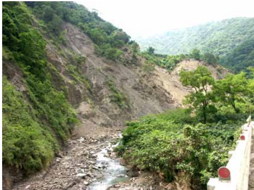
照片 2-63 S-03 災損情形(台 20 線綠茂橋西岸)
