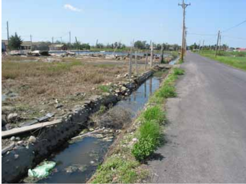
圖 2-52 溪頂村明聖宮北側排水
