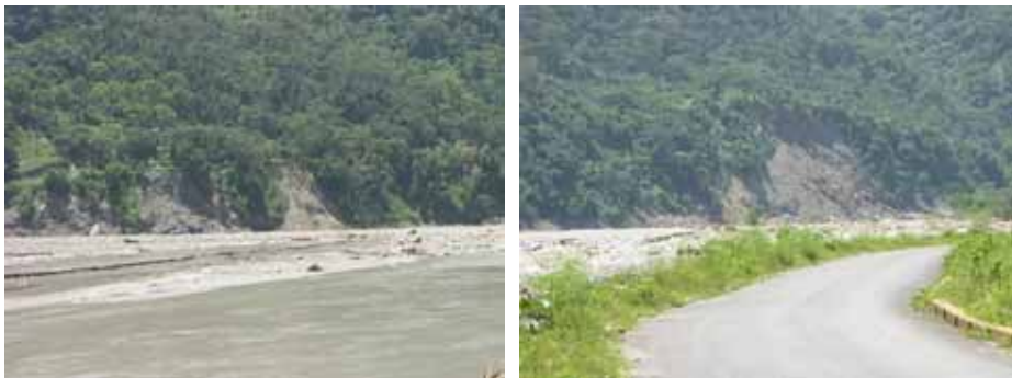
照片 2-92 S-23 災損情形(高雄 184 縣道 55K 處東南方)
