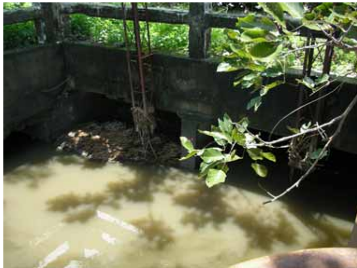
圖 2-3 下水道水位高且淤積嚴重
