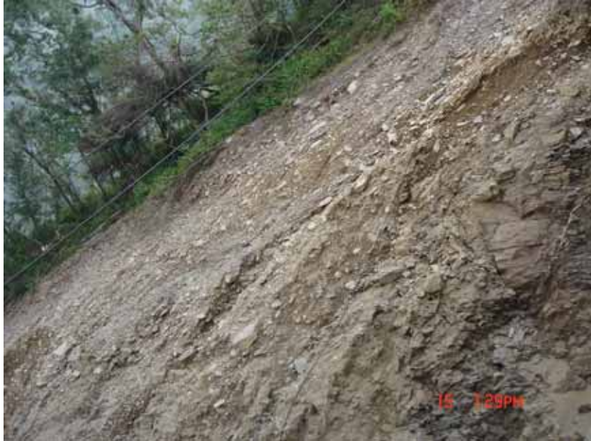
照片 2-75 S-10 災損情形(台 20 線 126k+600)
