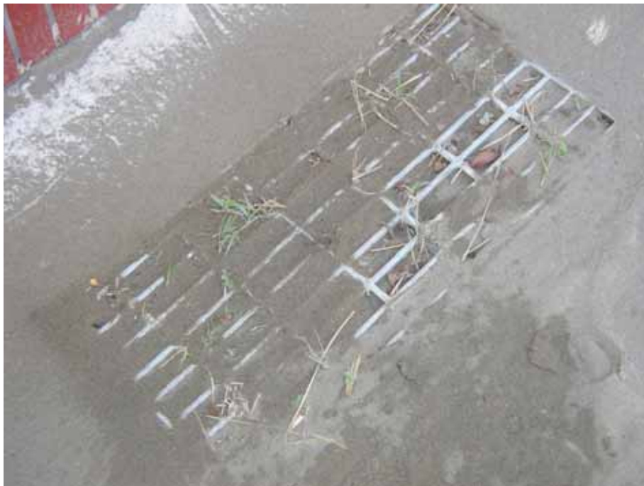
圖 2-13 水林鄉中庄路沿線側溝遭土砂淤塞
