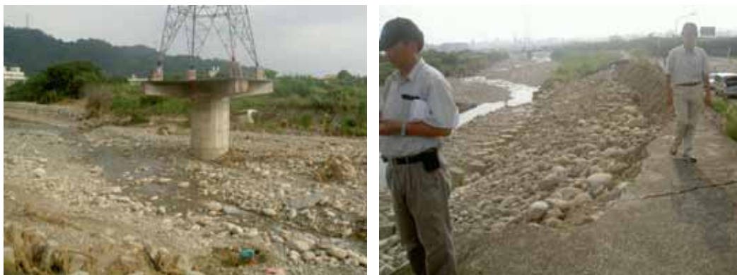
相片 44 河道中水工建造物妨礙水流通行（左），下游面堤防破壞情況（右）
