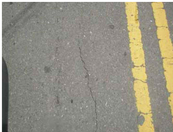
圖 2-15 水林鄉廟前街路面出現裂縫
