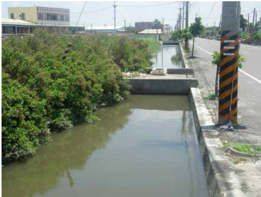
圖 2-22 口湖鄉內排水明溝水位均偏高
