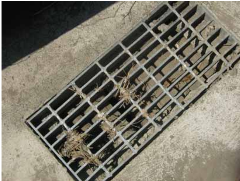
圖 2-11 水林鄉文化路側溝阻塞情形
