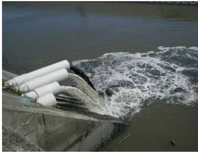
圖 2-9 海南村簡易排水設備出水口可見僅三座抽水機運轉正常
