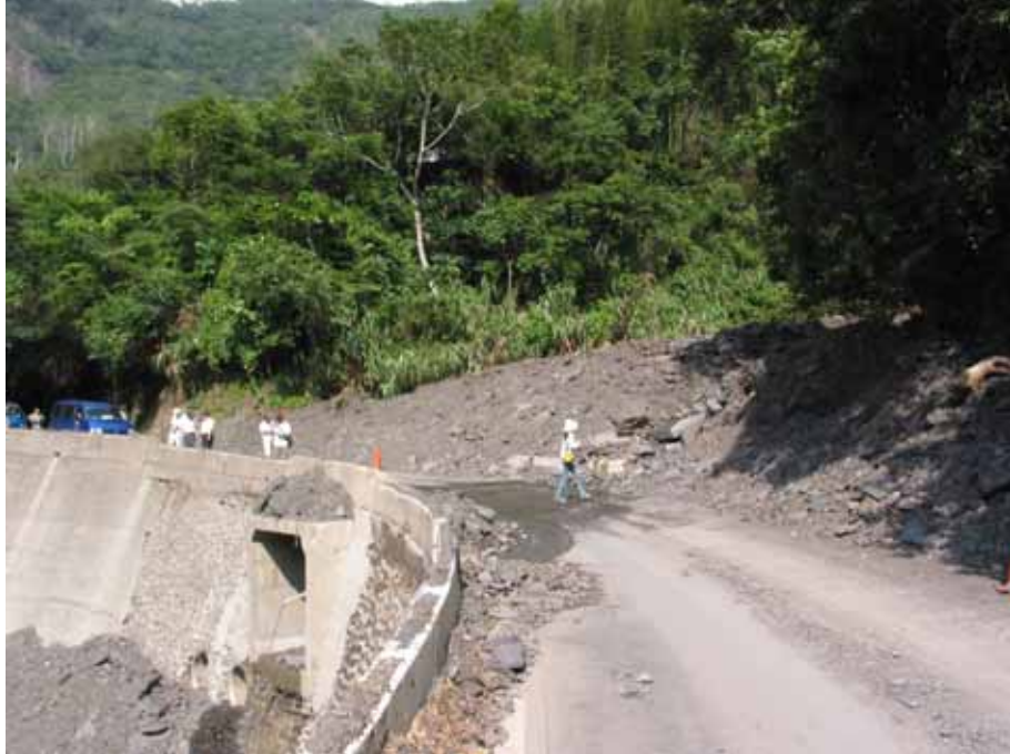
照片 2-71 S-08 災損情形(台 20 線 109k+50)
