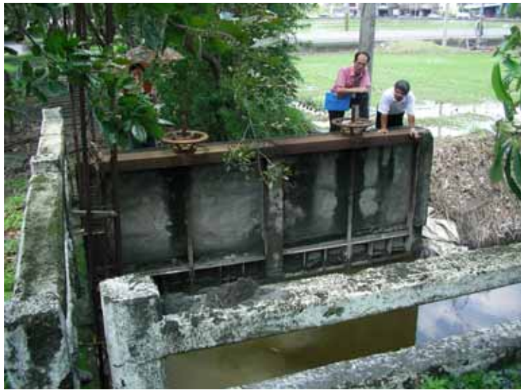
圖 2-2 現勘時下水道閘門仍未打開
