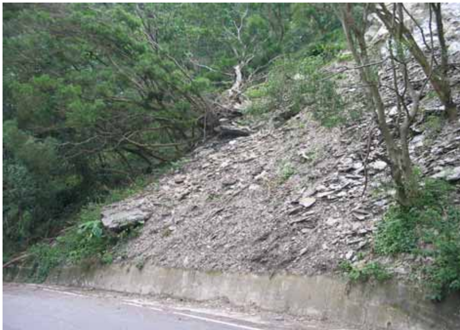
照片 2-97 S-28 受災情形(屏 31 號公路距三地門德文村約 2.2k)
