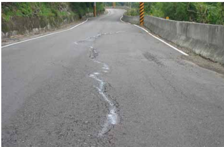
照片 2-96 S-27 受災情形(屏 31 號公路通往三地鄉德文村 2k)
