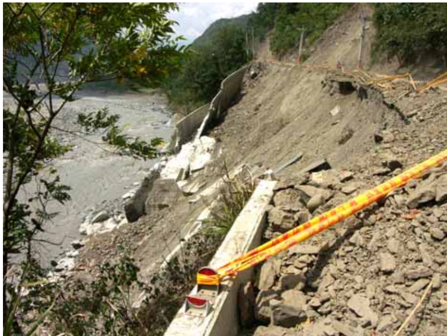
照片 2-67 S-06 災損情形(台 20 線 96k+400)
