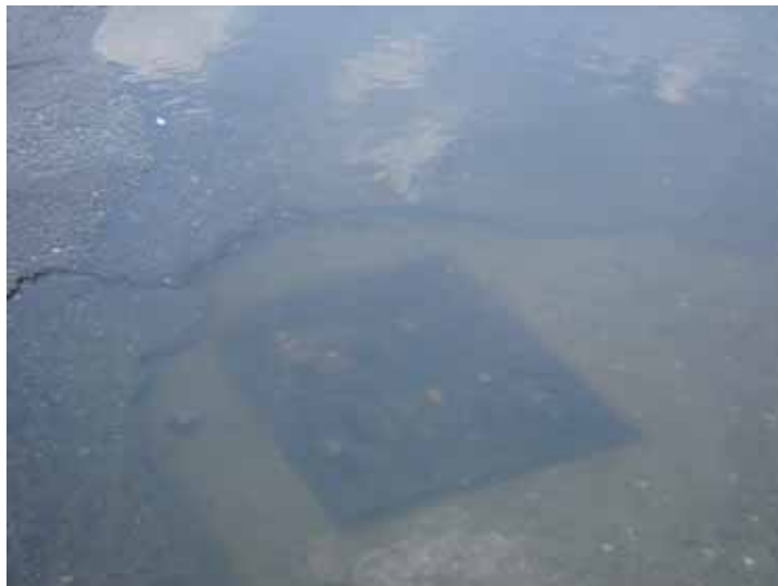
圖 2-5 側溝仍屬排水不良整段側溝均泡在水中
