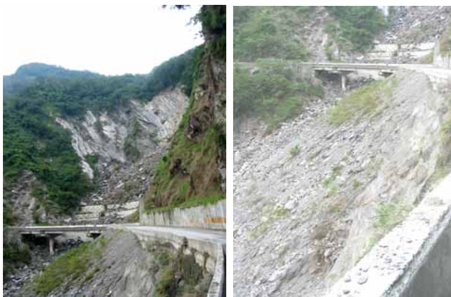
照片 2-78 S-12 受災情形(台 24 線 30k 處之邊坡)
