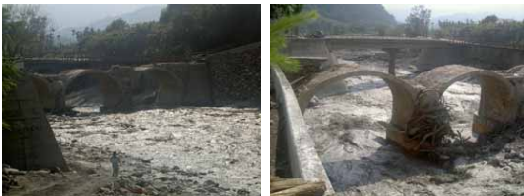
相片 45 糯米橋阻礙河道通水斷面（左），下游新建橋樑阻礙河道通水斷面（右）
