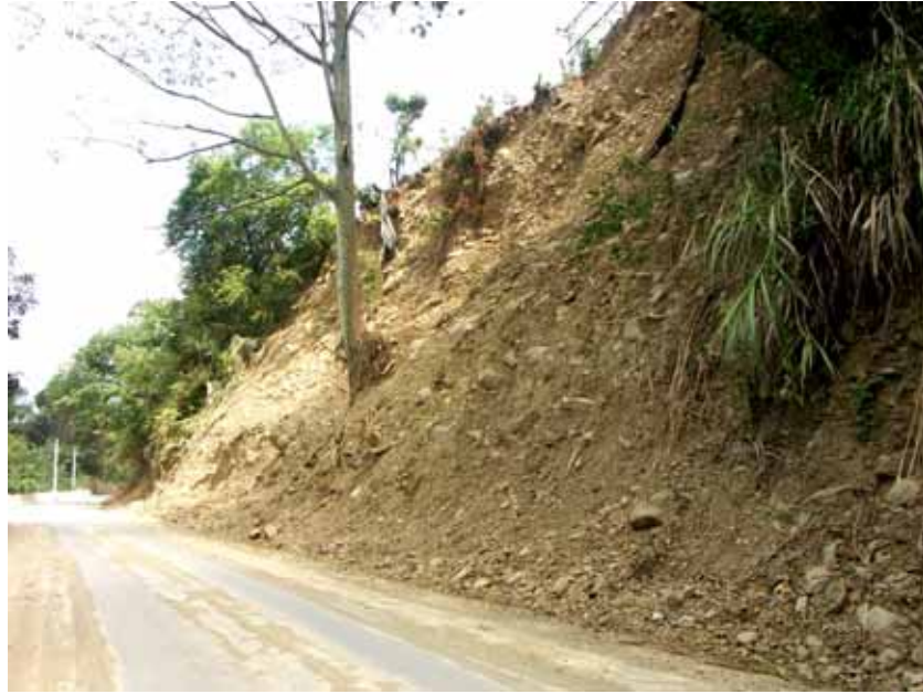
照片 2-64 S-04 災損情形(台 20 號公路 85~93.5K)
