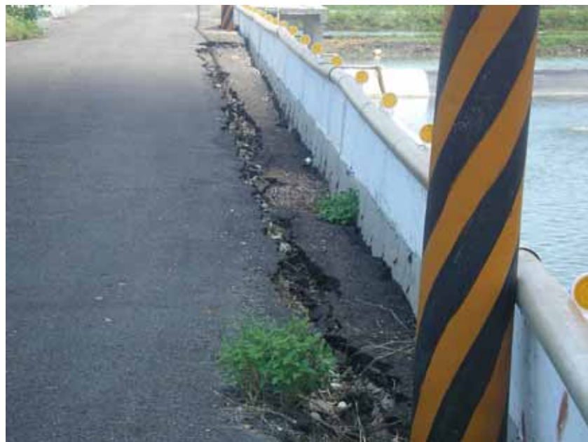
圖 2-24 淹水區路基遭沖蝕下陷
