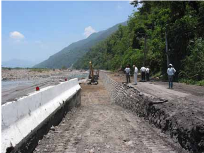
照片 2-85 S-19 災損情形(台 27 號公路 20K+200~+915)
