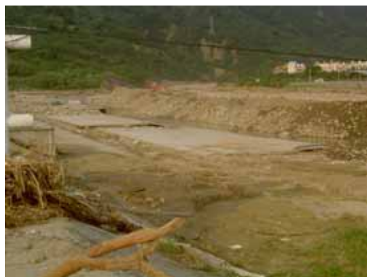
相片 39 一江橋上游河道土石淤積情況
