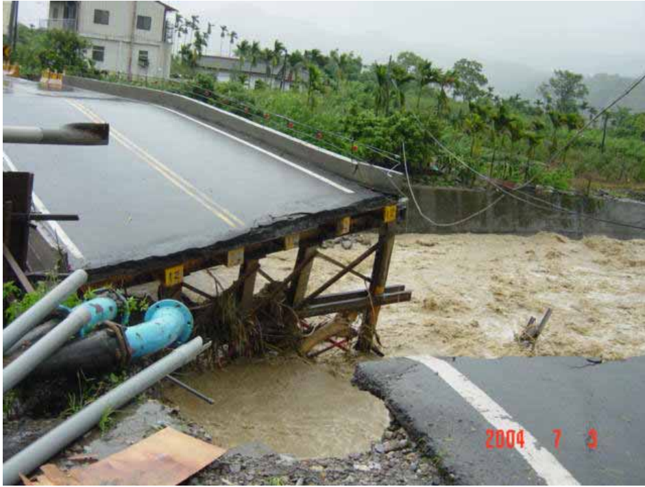
圖 3.6 永安橋斷裂[公路局(2004/7/3)]
