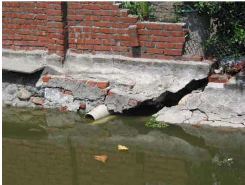
圖 2-31 頂湖村堤防損壞處
