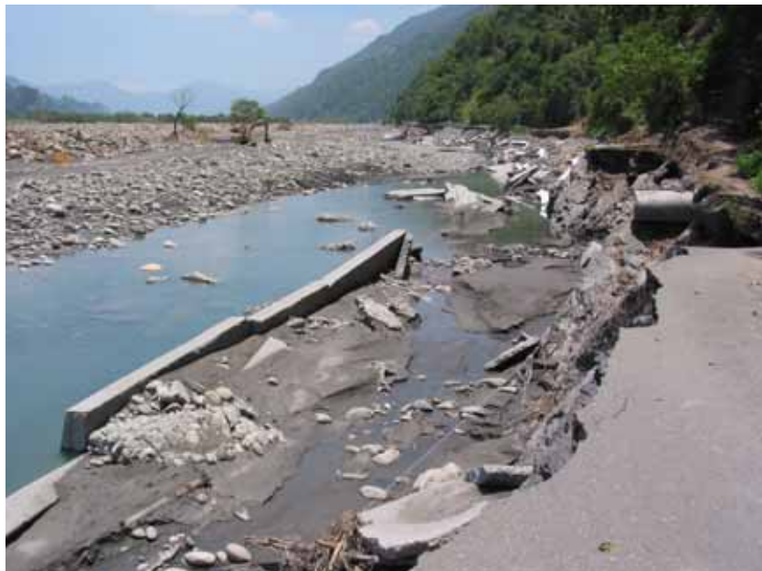
照片 2-86 S-19 災損情形(台 27 號公路 20K+200~+915)
