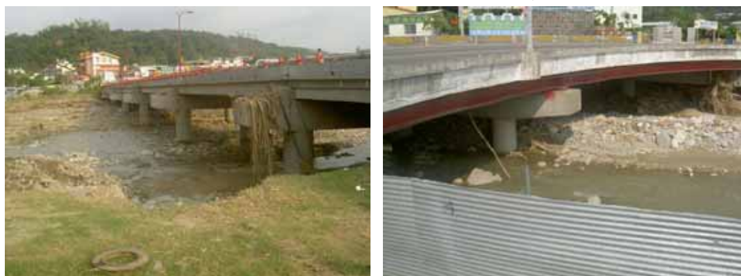
相片 40 一江橋通水斷面不足情況（左），金谿橋通水斷面不足情況（右）
