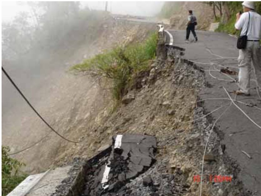
照片 2-76 S-10 災損情形(台 20 線 126k+600)
