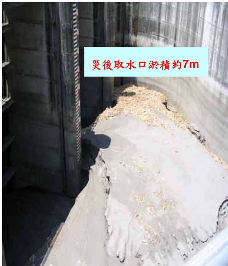
圖 2.7 馬鞍分廠災損情形
