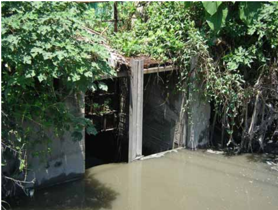
圖 2-1 土庫鎮閘門損害情形
