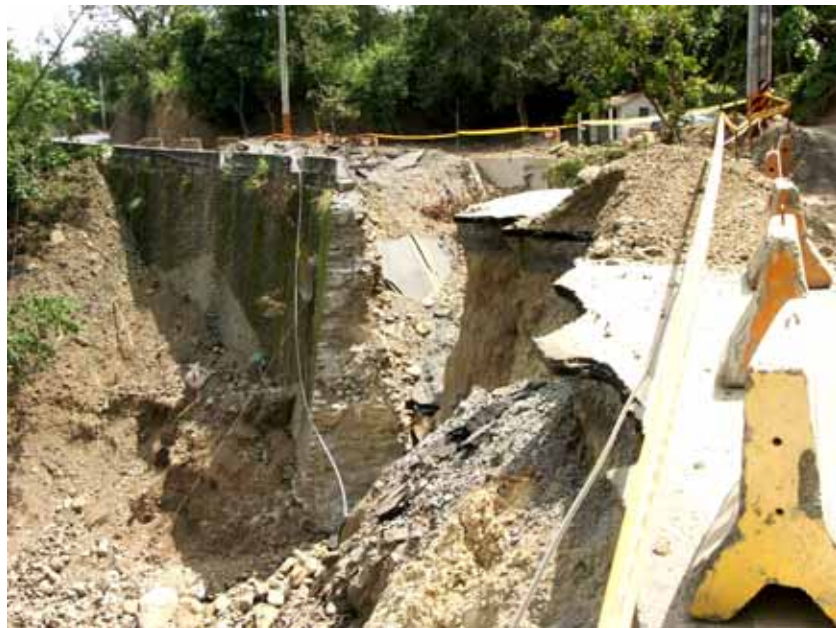
照片 2-65 S-04 災損情形(台 20 號公路 85~93.5K)
