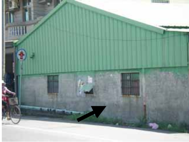
圖 2-16 水林鄉新興北路某住家牆壁可清楚看見淹水線
