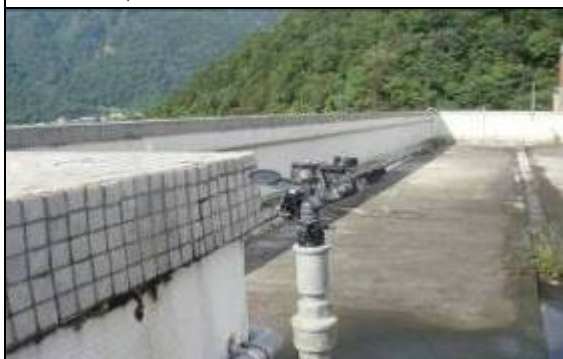
頂樓裝設灑水系統
