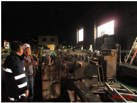
圖 66 災後火災現場檢討
