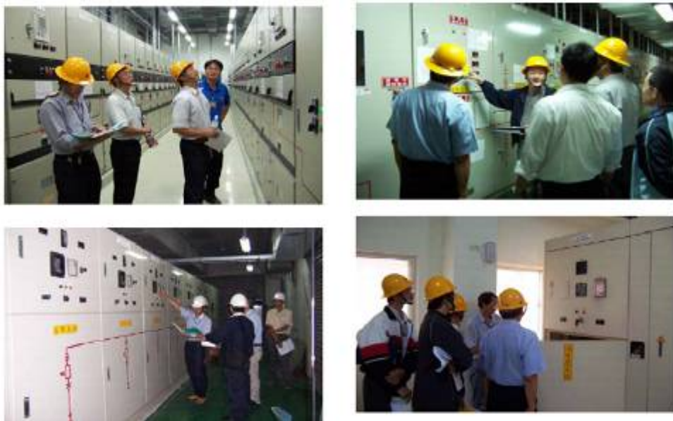
圖 11 南科電力診斷實況照片
