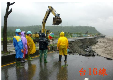
98年台16線路基坍塌
