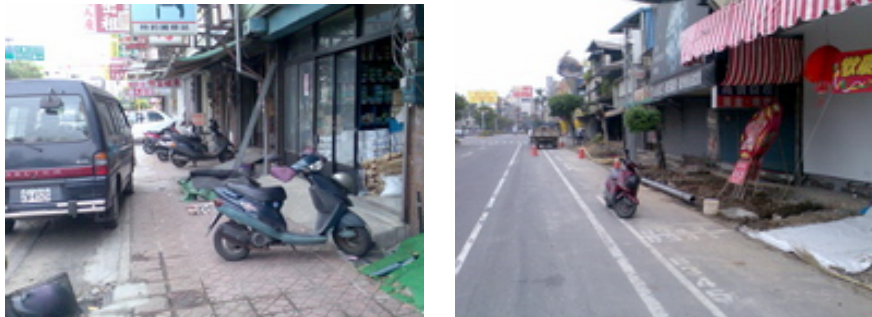
附圖 2.14 西側違規停車與東側施工現況
