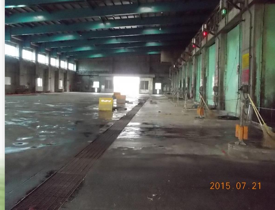
彰化縣溪州焚化廠傾卸平台堆置垃圾
