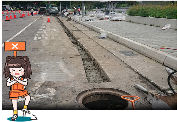
▲傳統智慧型站牌接電工程成本高昂、耗時費工
