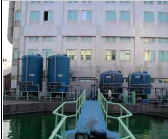
照片三、聯合水處理公司（沉澱池）
