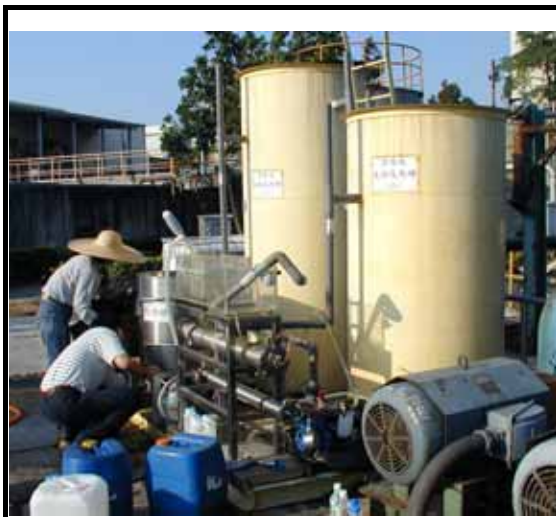
照片 5-1 NF 及 RO 膜管現場模試
