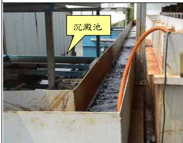
照片 3、曝氣渠道及沉澱池
