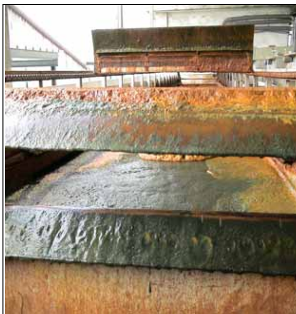
照片 1、污泥刮除設備
