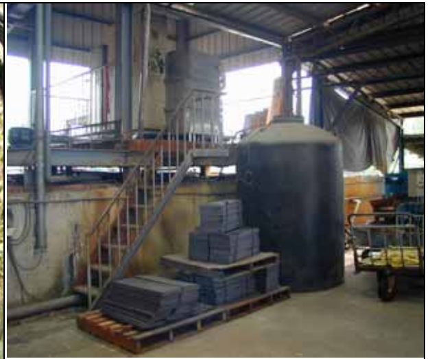
照片二、電凝設備（處理高濃度水）
