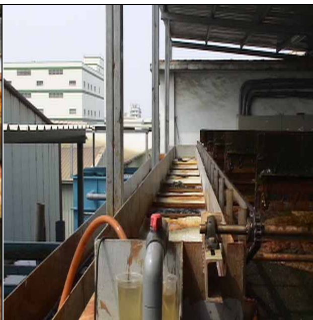
照片 2、曝氣渠道
