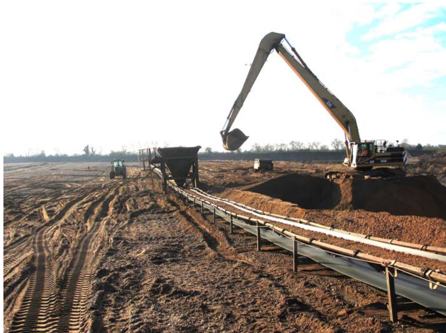
圖四 挖掘場址設計了輸送帶的設備，取代傳統大型卡車的運送工作，以減少噪音及塵土飛揚的空氣污染。
