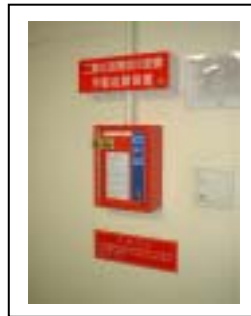
圖(一)3-1-14 消防設施
