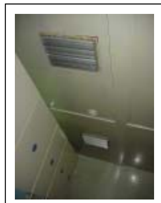
圖(一)3-1-49 地下室膠片庫鋼板天花
