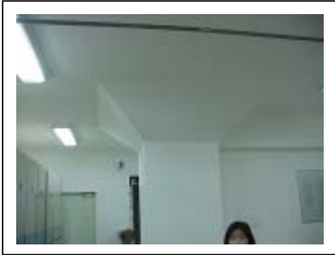
圖(一)3-1-42 庫房無樑板與垂直柱樑交接
