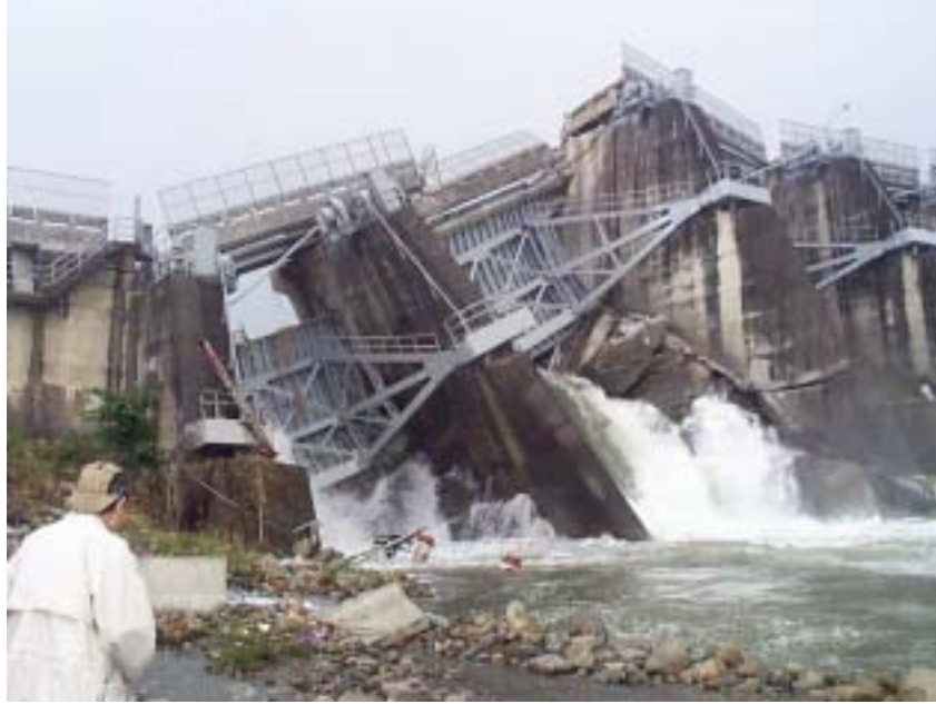
圖 3.1、石岡壩受損狀況
