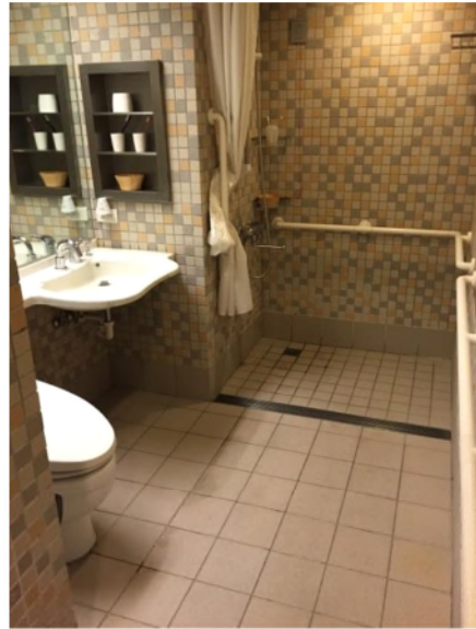
圖 4-6 長庚養生文化村住所內浴室設施
