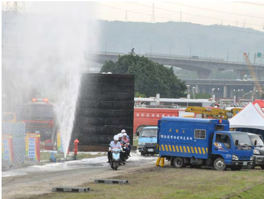
照片 8 公共事業單位負責維生管線搶修
