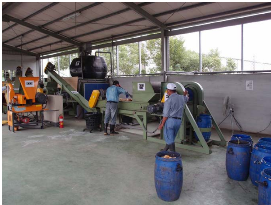
附圖 4-6 大社區廚餘堆肥處理設備
